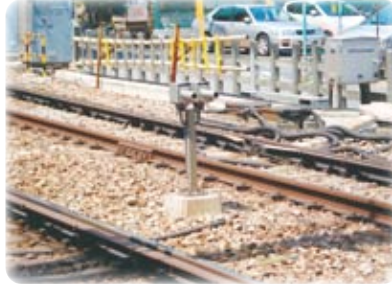
▲踏切支障報知装置
